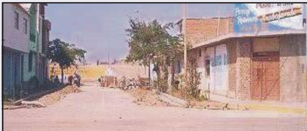
Calle Monjoy construcción de sardineles y ornamentación de jardineras, se invirtió 14 233.00 nuevos soles.
